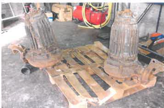
Lote D: Bombas de Estação Elevatória
