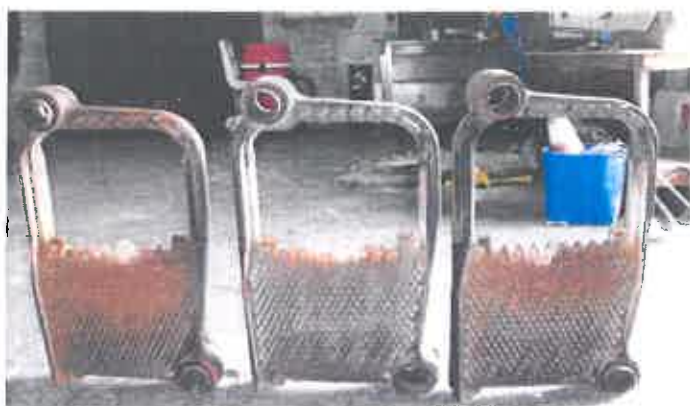
Lote G: Elementos das caldeiras do ar condicionado
