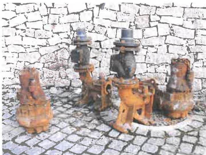
Lote F: Bombas de Estação Elevatória e Ligadores de bombas de tubagem
